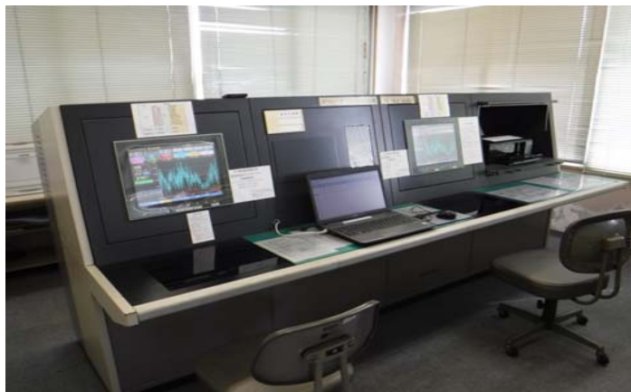
関第 2 水源地の中央監視制御装置
