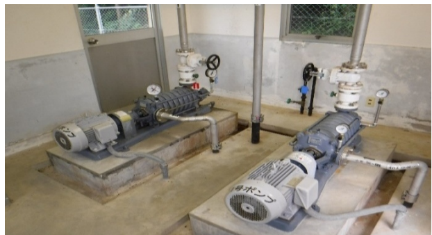
関南部加圧ポンプ
