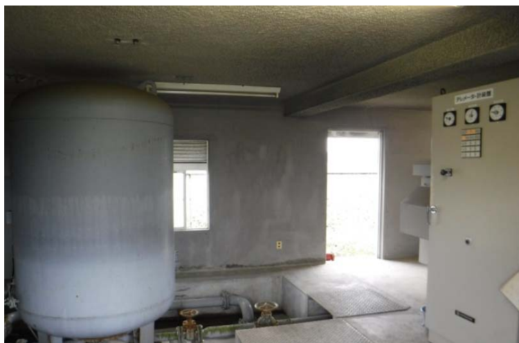
川崎加圧ポンプ
