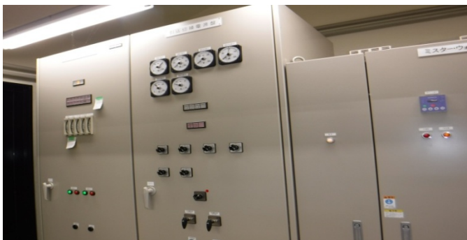
加圧ポンプ制御盤
