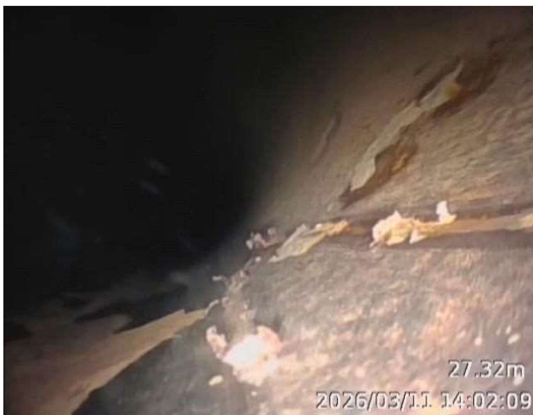
— 上流側 27.32m シールコート剥離、スケール —
