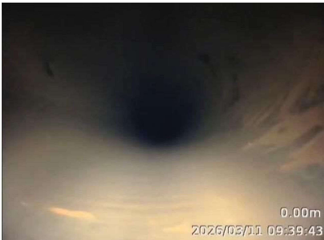
— 上流側 0.00m シールコート剝離、スケール —
