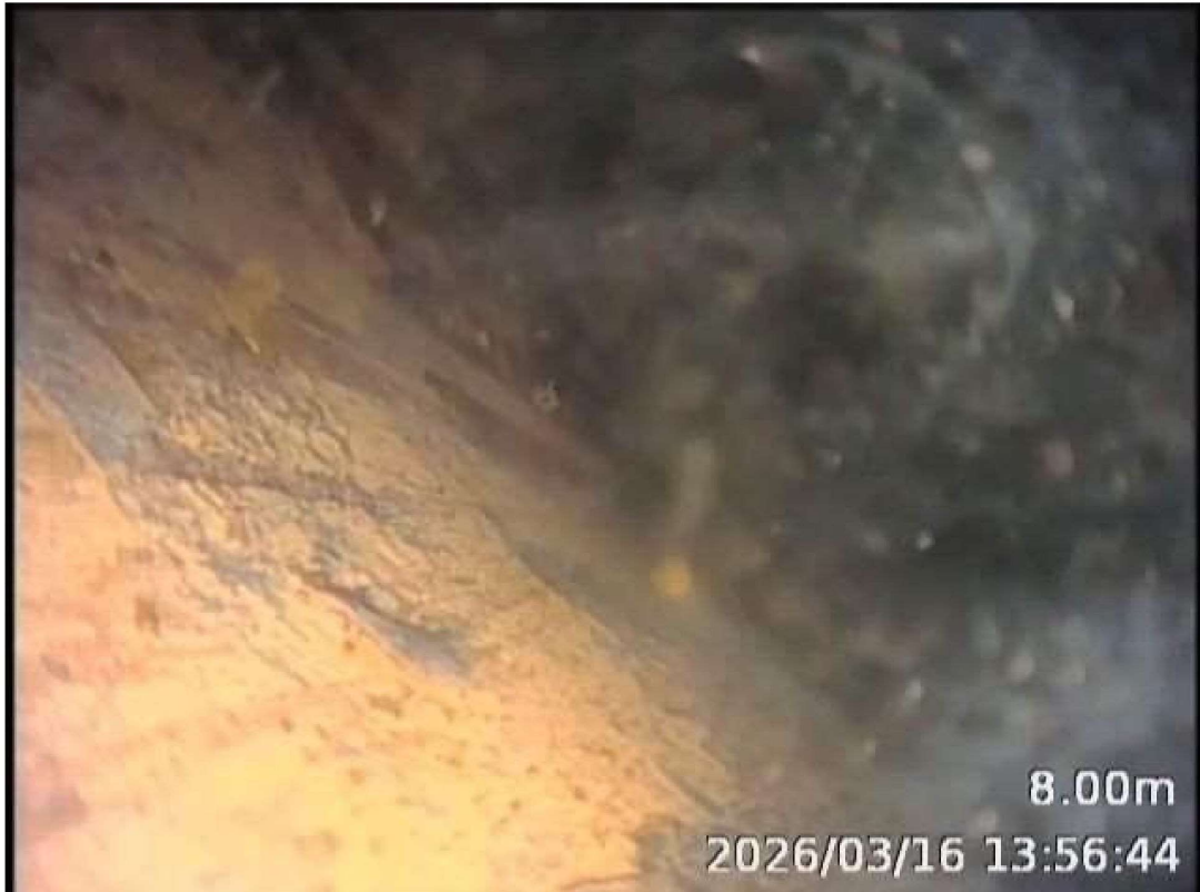
— 上流側 8.00m 管内面スケール —
