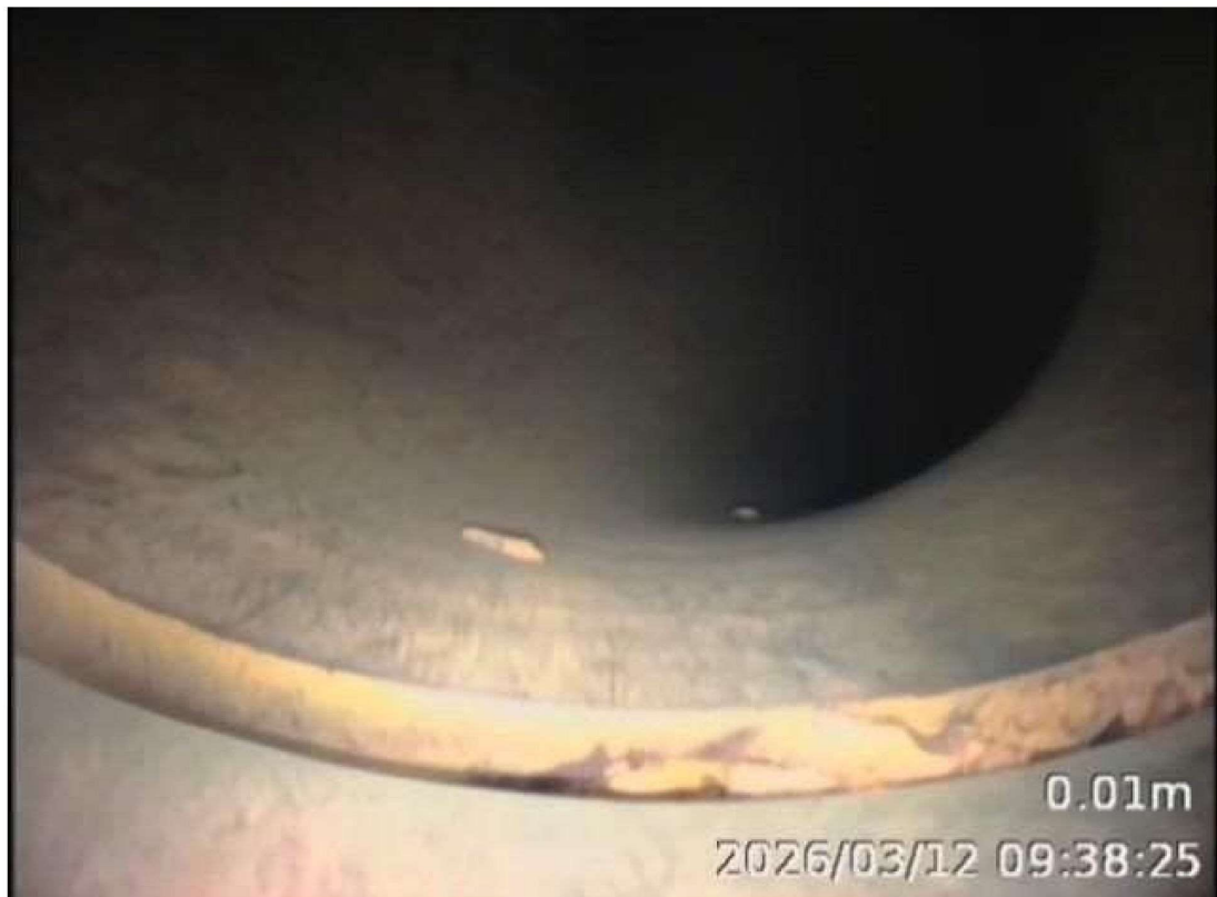
— 上流側 0.01m 継手錆 —
