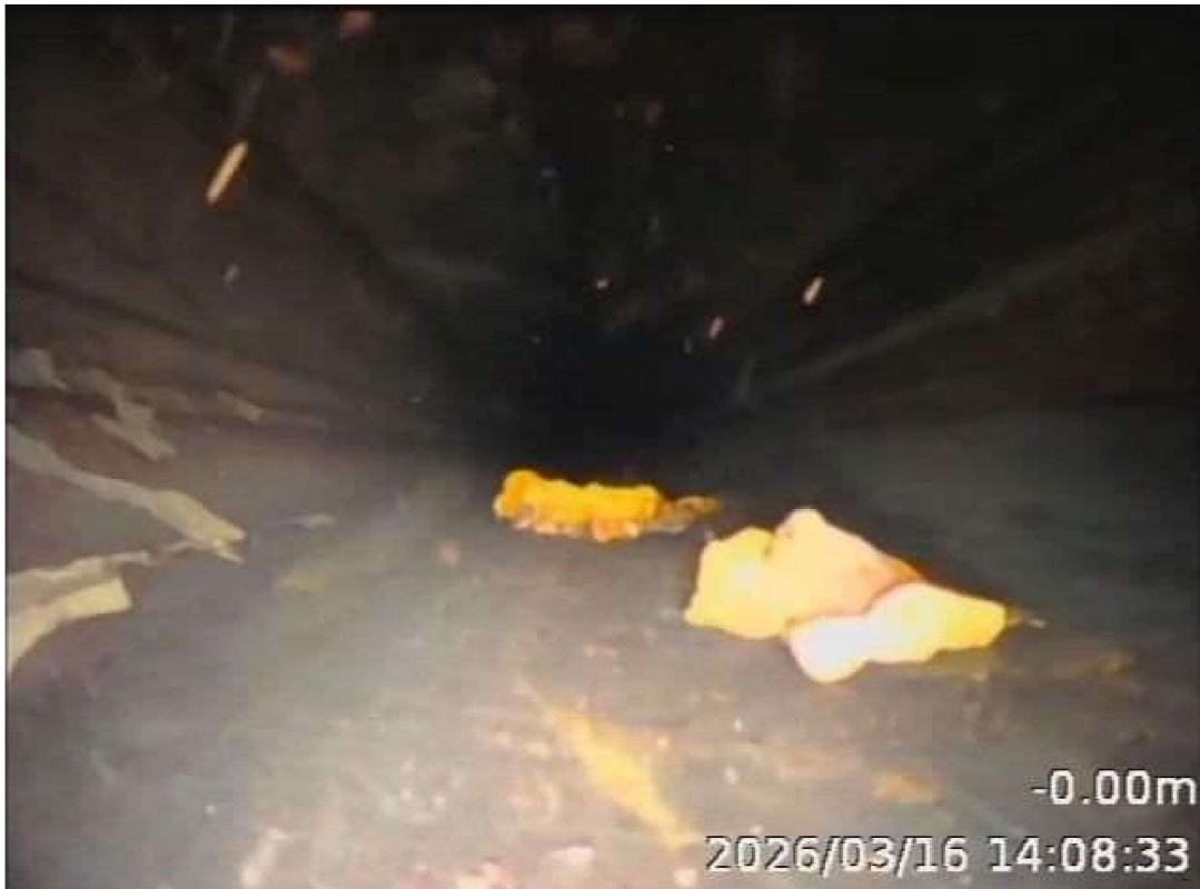
— 下流側 0.00m 錆片 —
