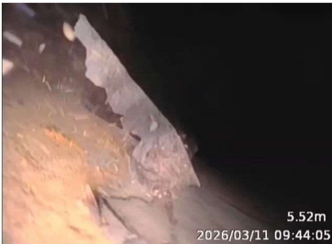
— 下流側 5.52m シールコート剝離 —
