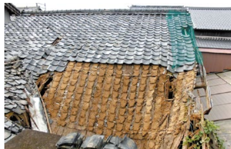
天井が抜け、屋根瓦がはがれ落ちていた。
