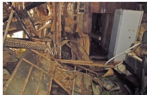
家屋が傾き、雨漏りや建具の損傷が見られた。
