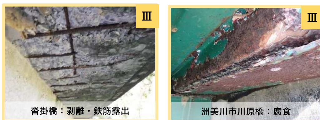
図 11 床版の判定区分Ⅲの例
