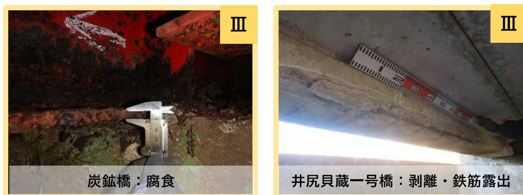
図 9 主桁の判定区分Ⅲの例
