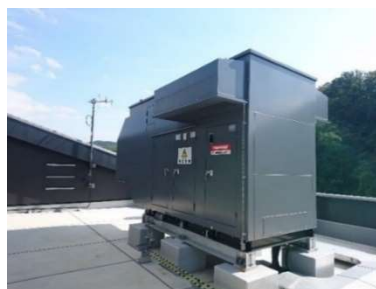
自家発電(土岐市)
