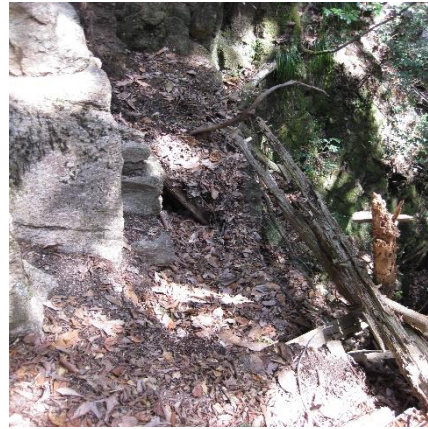
右岸側 木橋が朽ちて谷側に落下、谷沿いに迂回コース (15)
