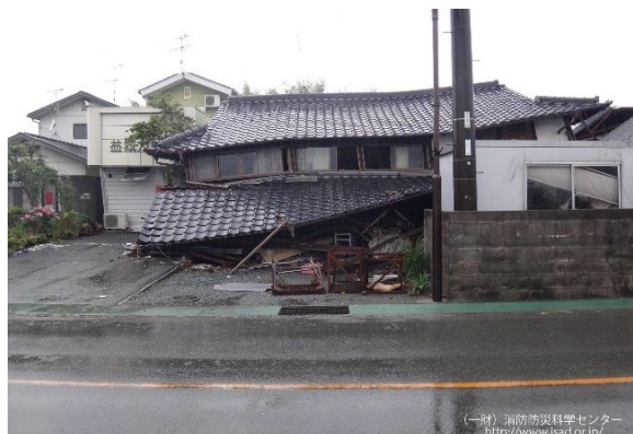
熊本地震（平成28年）で倒壊した住宅
