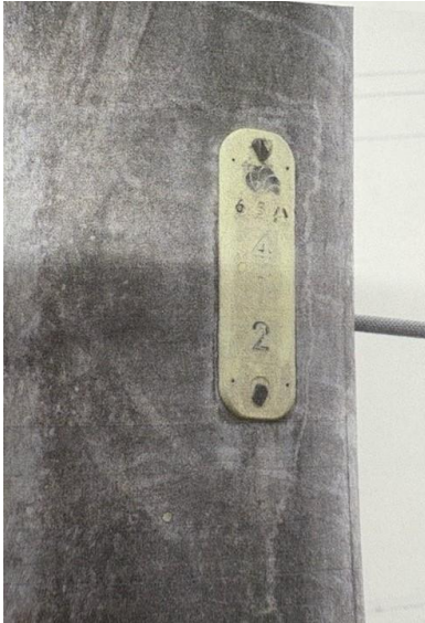
設置場所の電柱番号札 （中部電力電柱番号）
