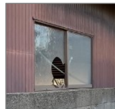
窓が割れた管理不全空家
