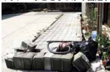
<地震で倒壊したブロック塀>
