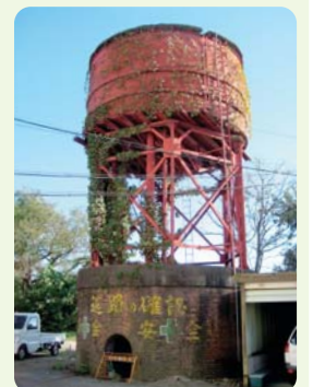
⑤ 高架貯水槽
