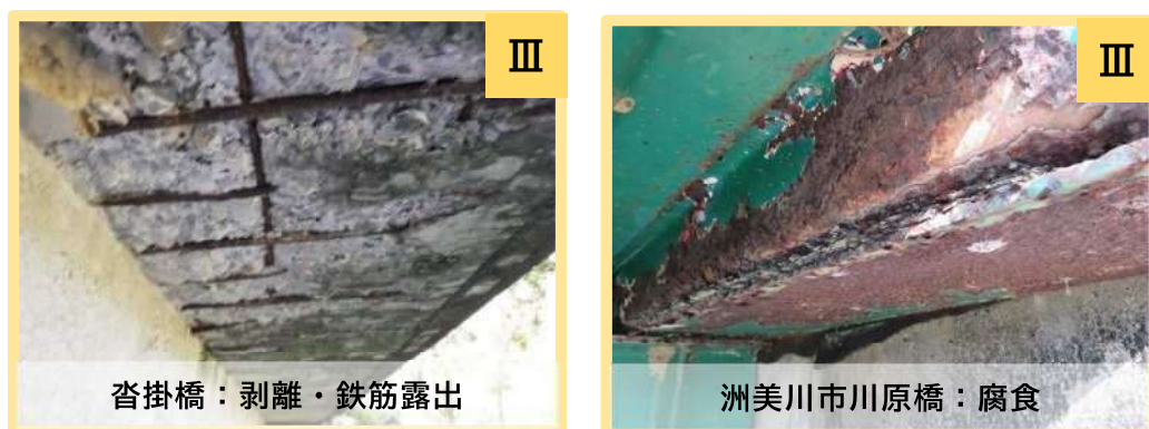
図 11 床版の判定区分Ⅲの例
