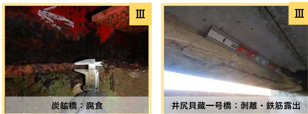
図 9 主桁の判定区分Ⅲの例
