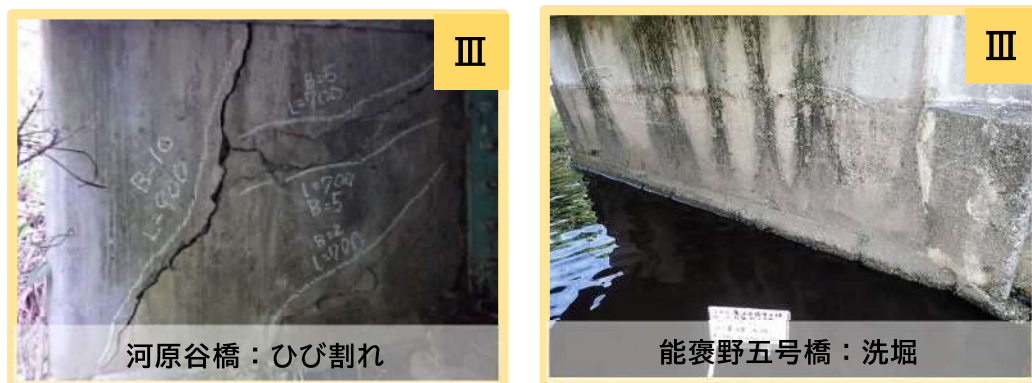
図 13 下部工の判定区分Ⅲの例
